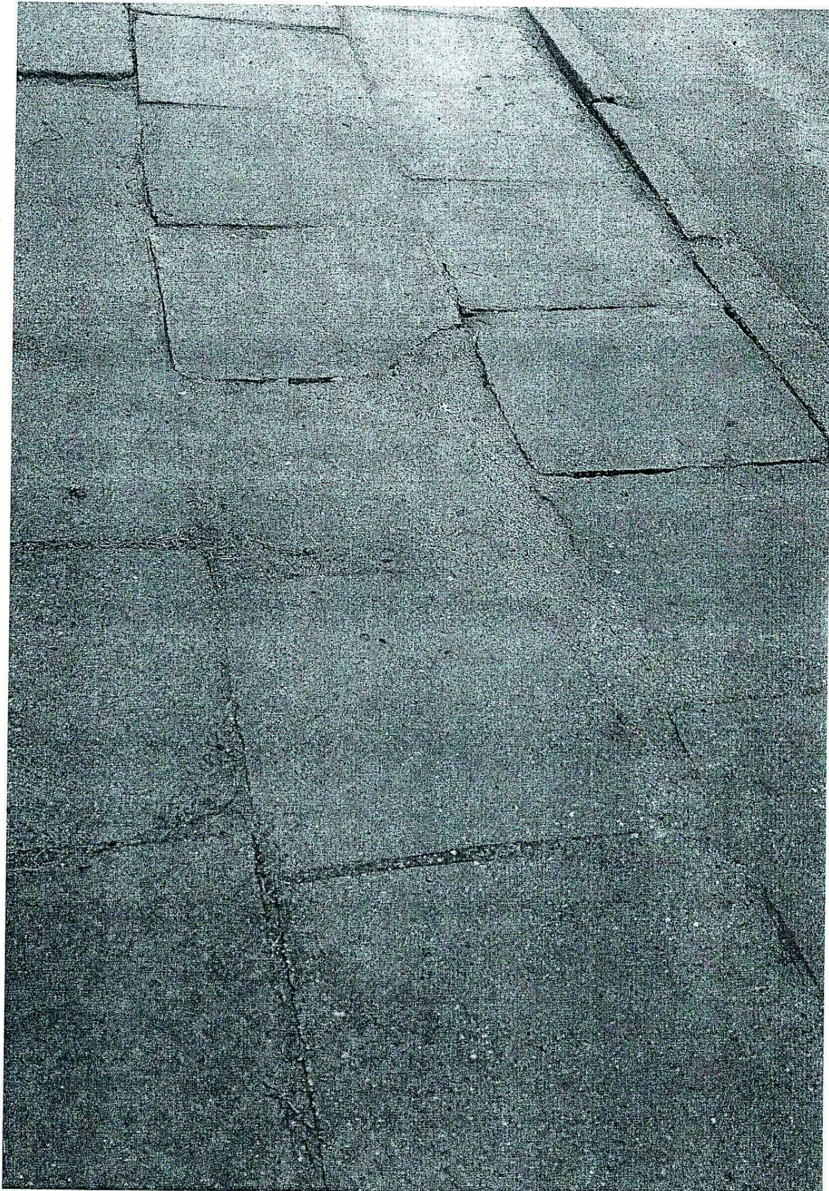
11. Zapadnięcia chodnika przy ul. Paderewskiego w środkowej części ulicy
