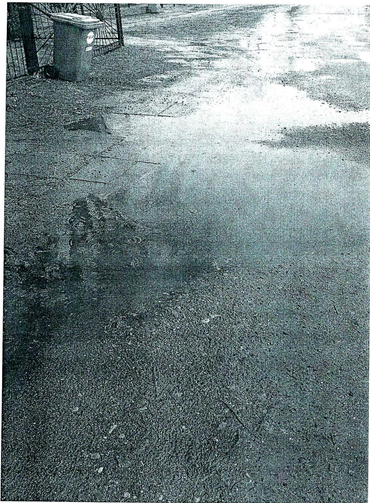
8. ul. Paderewskiego w Pasłęku z nieprzejezdnym chodnikiem po opadach
