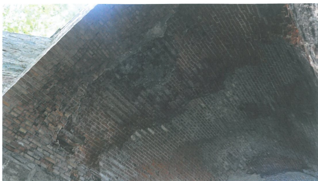
Wnętrze łuku, na skraju widoczne równoległe pęknięcia, rozległy ubytek lica, betonowe uzupełnienia, zasolenia partii muru
