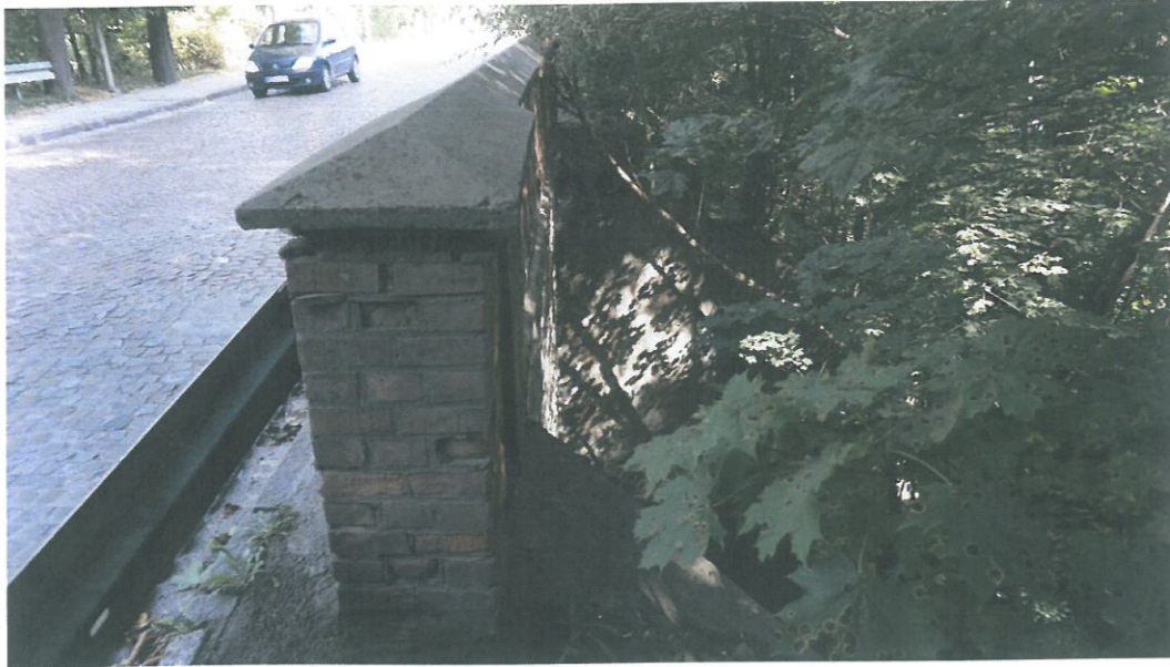
Balustrada od strony jezdni, widoczne odspojenie nakrywy
