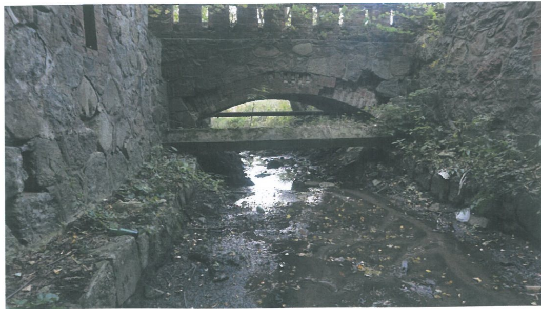
Uszkodzenie wątku kamiennego i ceglanego w łuku- odspojenie i osiadanie całego fragmentu.
