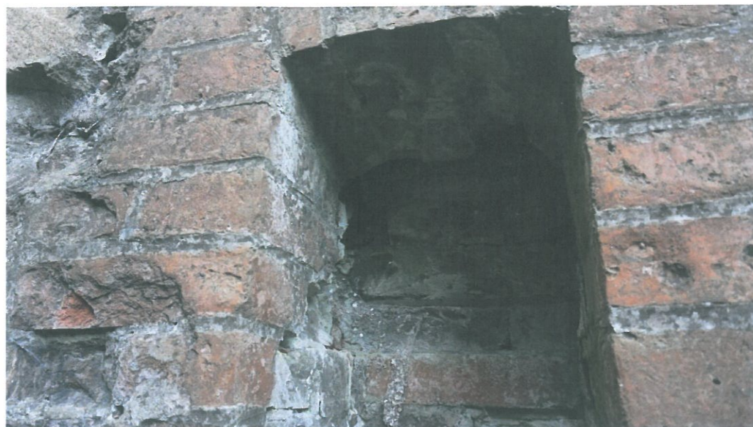
Otwór wykończony cegłą, widoczne rozspojenie wewnątrz
