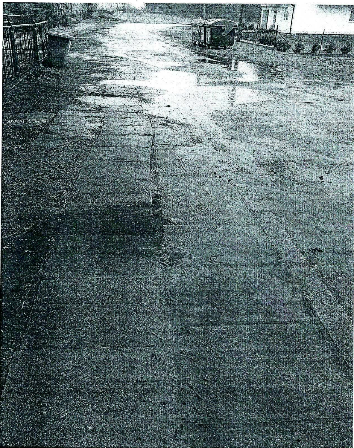
6. Widok dziur i zapadnięć ulicy Paderewskiego i zapadniętymi płytkami chodnikowymi
